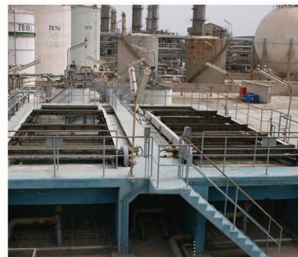
نمایی از سیستم تصفیه خانه پتروشیمی بندرامام
